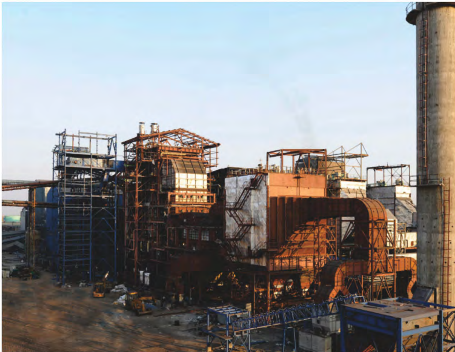
Central électrique Cogen 30 MW sur la base de EPC, y compris travaux de génie civil pour Shree Renuka Sugars Ltd., Inde.
