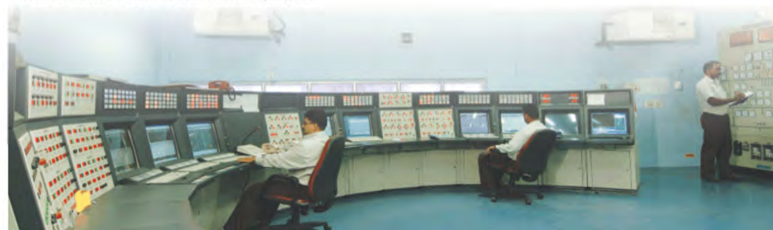
Salle de contrôle de la chaudière à Chennai Petroleum Corp. Ltd., Inde.
