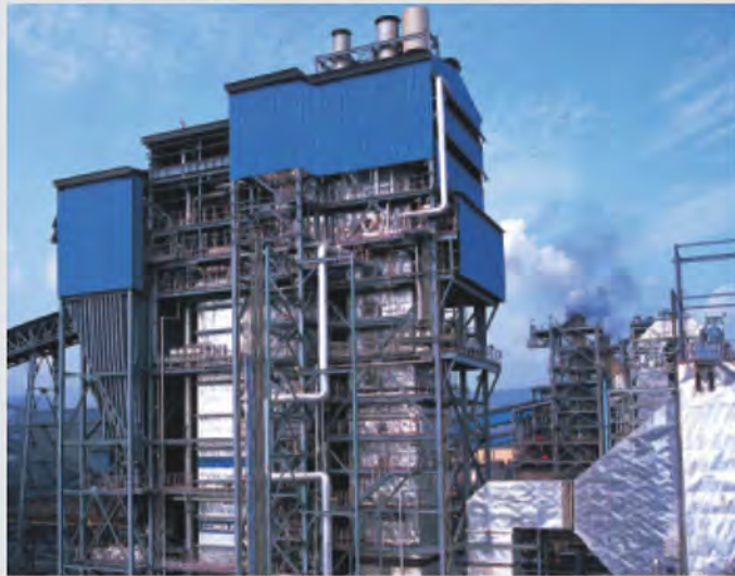
Chaudière compacte CFBC de 150 TPH avec séparateur, Jindal Steel & Power, Raigarh, Inde.
