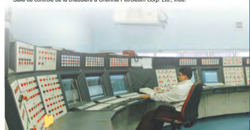
Salle de contrôle de la chaudière à Chennai Petroleum Corp. Ltd., Inde.
