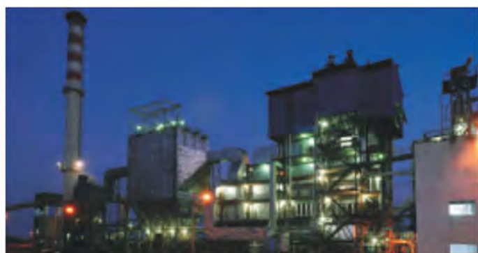
90 TPH, 50 kg/cm 2 . g, 485 deg. C Chaudière AFBC alimentée au charbon de Gujarat Flourochemicals Ltd. en Inde.
