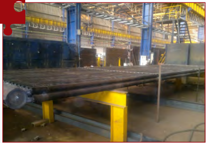
HPCL, Mumbai: HRSG Modification of BHEL Boiler
